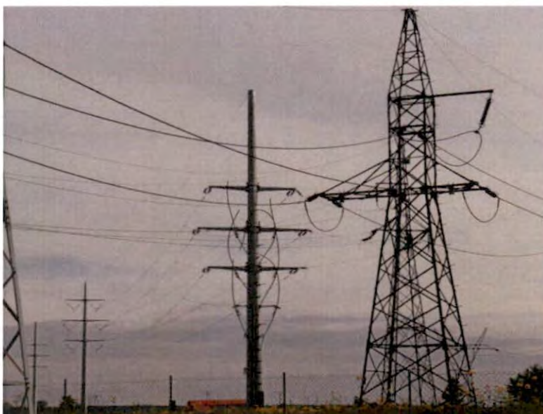
Fot. 3. Linie dystrybucyjne 110 kV (przykłady słupów)
