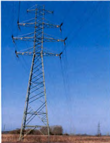
a) Linia dwutorowa 110 kV
