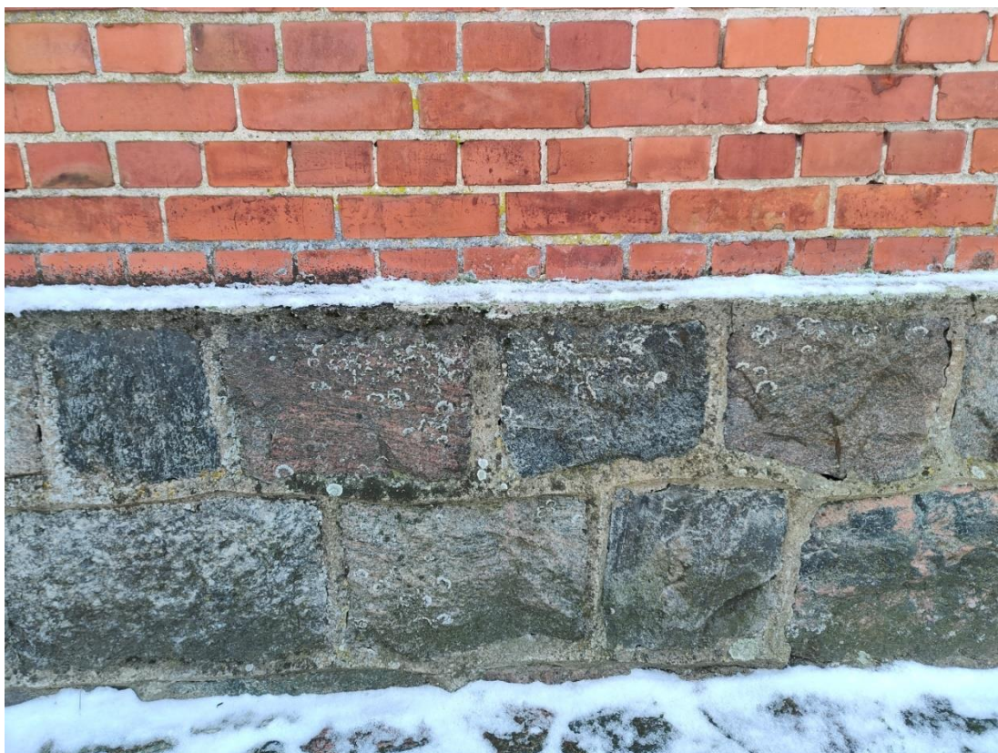
Widok zabrudzeń istniejącego cokołu kamiennego
