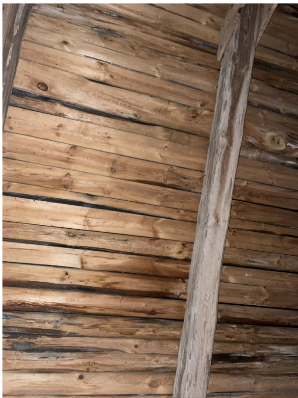
Widok deskowania przeznaczonego do wymiany
